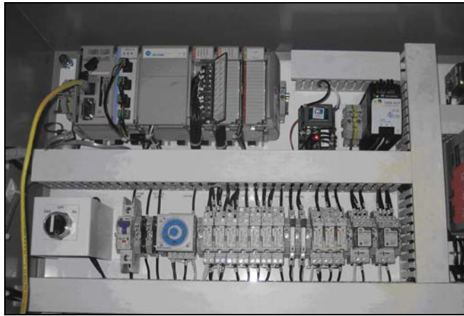
Figure 3-3. Vérifier tous les câblages et raccordements
